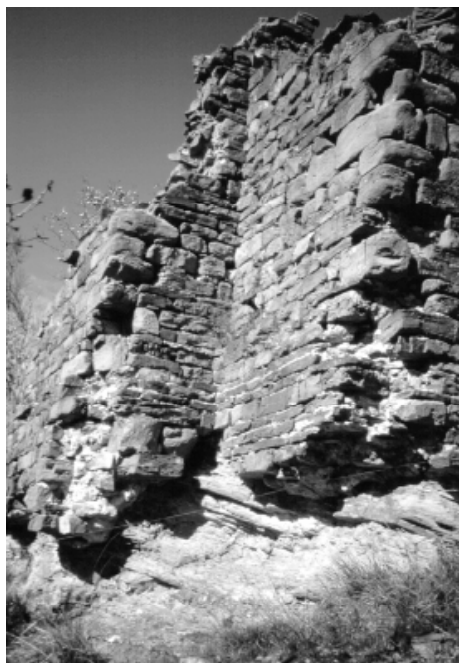
Rocca di Cerbaia: particolare delle mura esterne (con evidente erosione dello strato geologico di appoggio) della chiesetta esterna alla rocca
