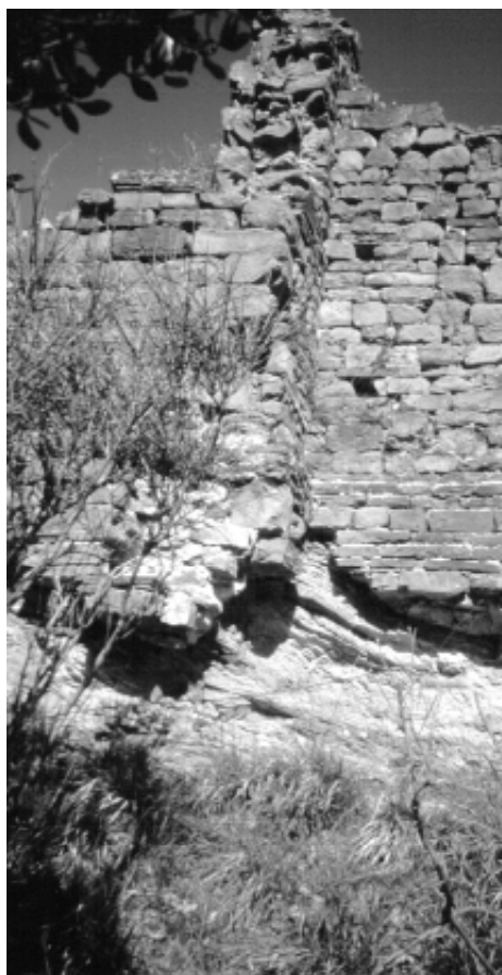
Rocca di Cerbaia: particolare delle mura (con evidente erosione dello strato geologico di appoggio) della chiesetta esterna alla rocca
